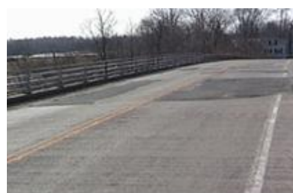
Эксплуатация моста с использованием «ЭКО- ОТТЕПЕЛЬ» с 1979 года без ремонта.
